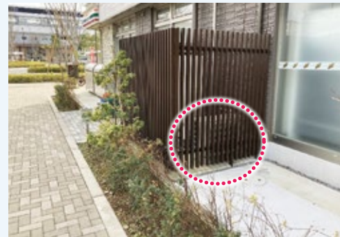
【事例】室外機等を格子で囲った修景
